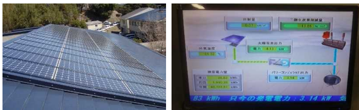
水産技術研究所（南勢庁舎）に設置された太陽光発電パネル（左）及び発電状況を表示するパネル（右）
