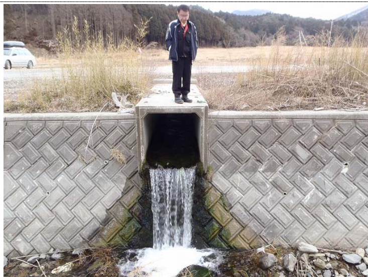
水源自噴水の河川排水
