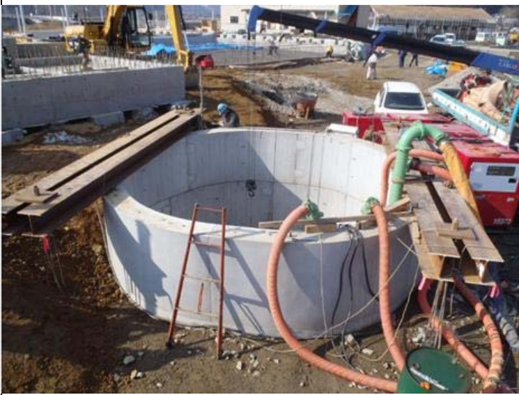
揚水井戸（旭ボーリング）
