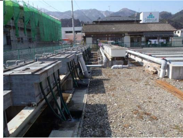
左側の浮上槽は下安家ふ化場から譲渡
