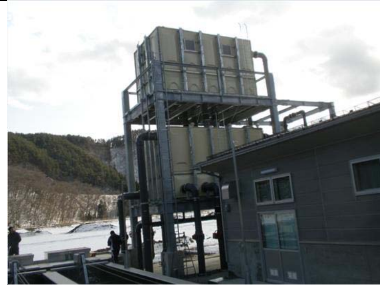
曝気槽、配水槽
