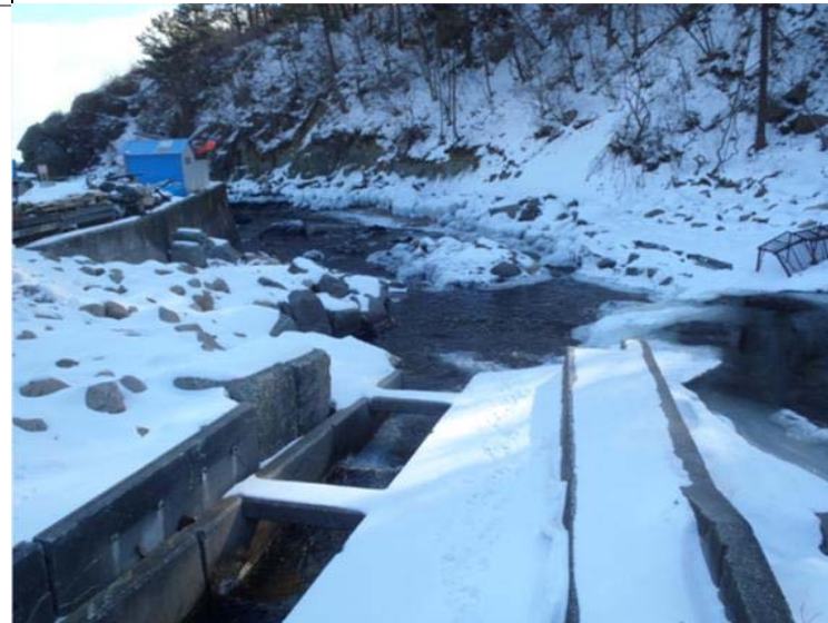
放水路(魚道):河川表層は結氷
