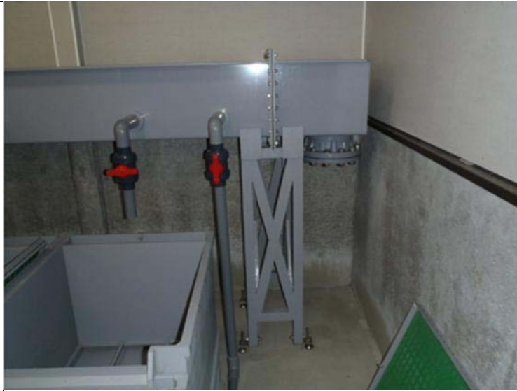
親槽のオーバーフロー管はフランジで止められている
