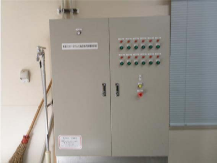
自動清掃機操作盤(小泉鉄工製)は、ふ化室内に設置
