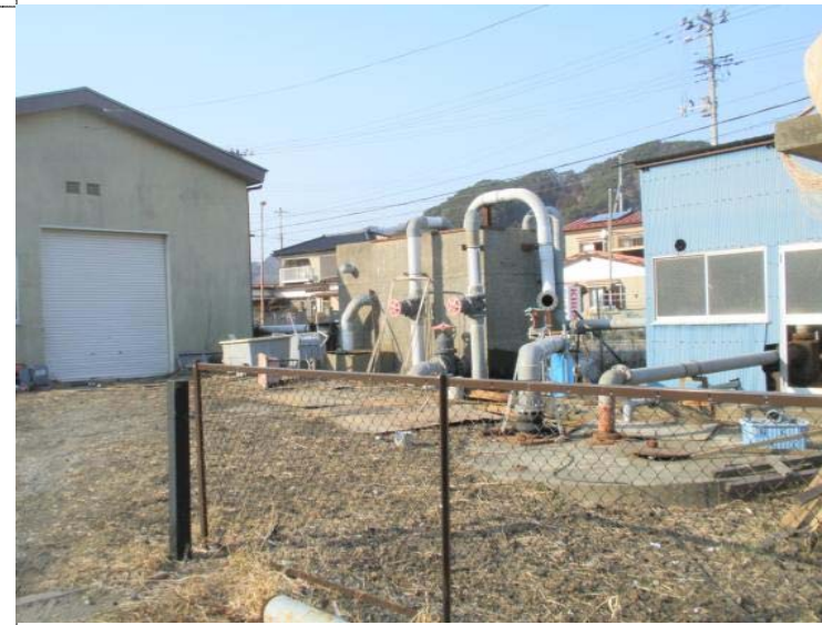
第1施設井戸:ふ化室用で揚水中
