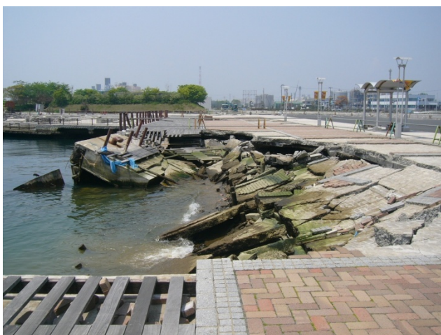
図3.破壊された小名浜港岸壁
