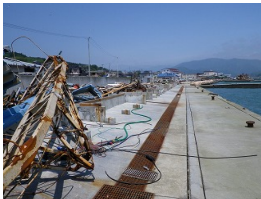
図-2.5.8 養殖作業小屋の被災状況（調査場所⑧）
