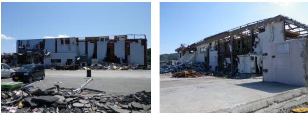
図-2.4.5 水産倉庫の被災状況（調査場所④）
