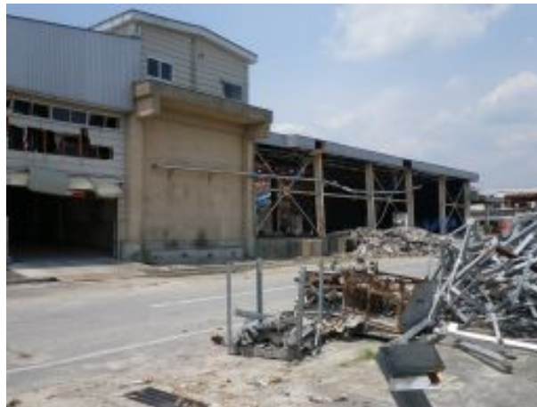
図-2.3.5 冷蔵庫の被災状況（調査場所③）
