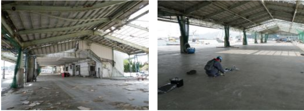
図-2.3.2 荷捌き所の被災状況（調査場所①）
