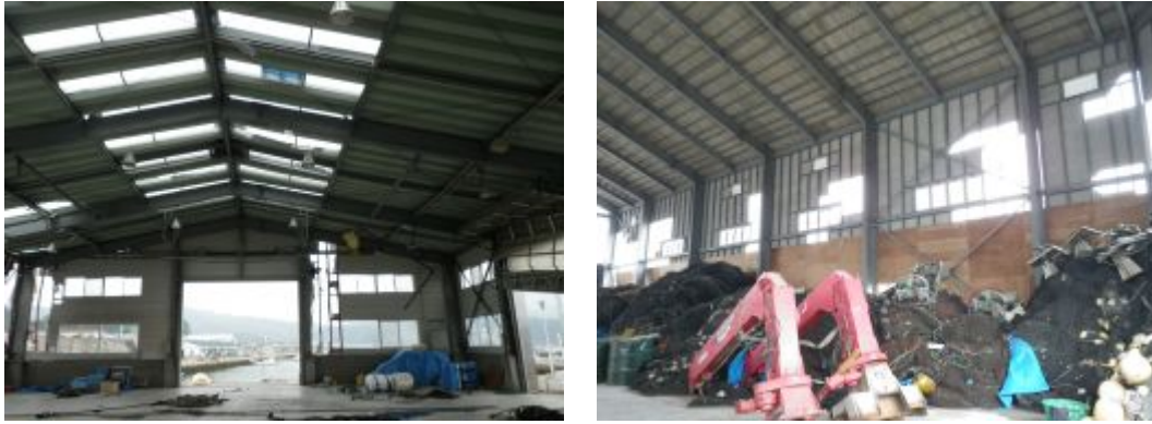
図-2.3.6 漁具倉庫の被災状況（調査場所④）
