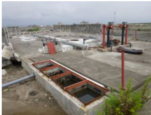
図-2.10.4 給油施設の被災状況（調査場所②）
