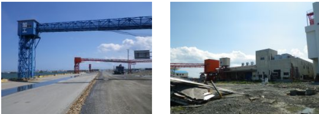
図-2.9.3 製氷施設の状況(調査場所②。左:給氷塔、右:製氷工場建屋)
