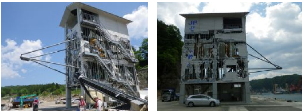
図-2.2.3 製氷施設の被災状況(調査場所②)
