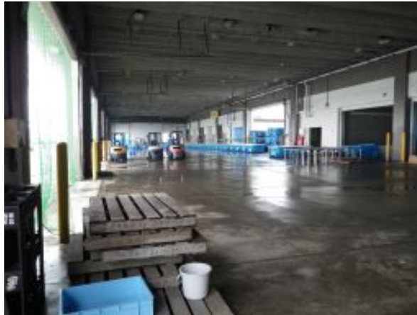
図-2.1.2 復旧作業中の魚市場の状況（調査場所①）
