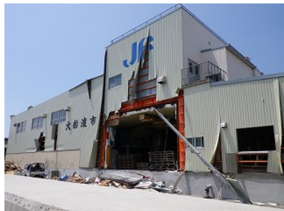
図 2.5.6 漁協の冷蔵庫の被災状況 (調査場所⑤)
