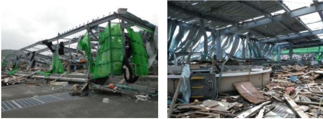
図-2.4.4 県水産技術センターの被災状況（調査場所③）
