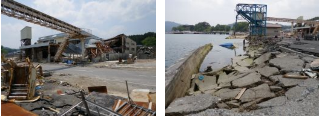
図-2.3.4 製氷施設の被災状況（調査場所②）
