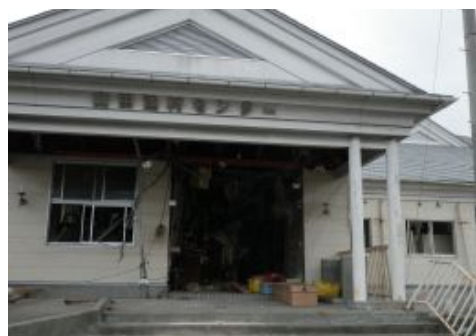
図-2.3.8 漁村センターの被災状況（調査場所⑥）
