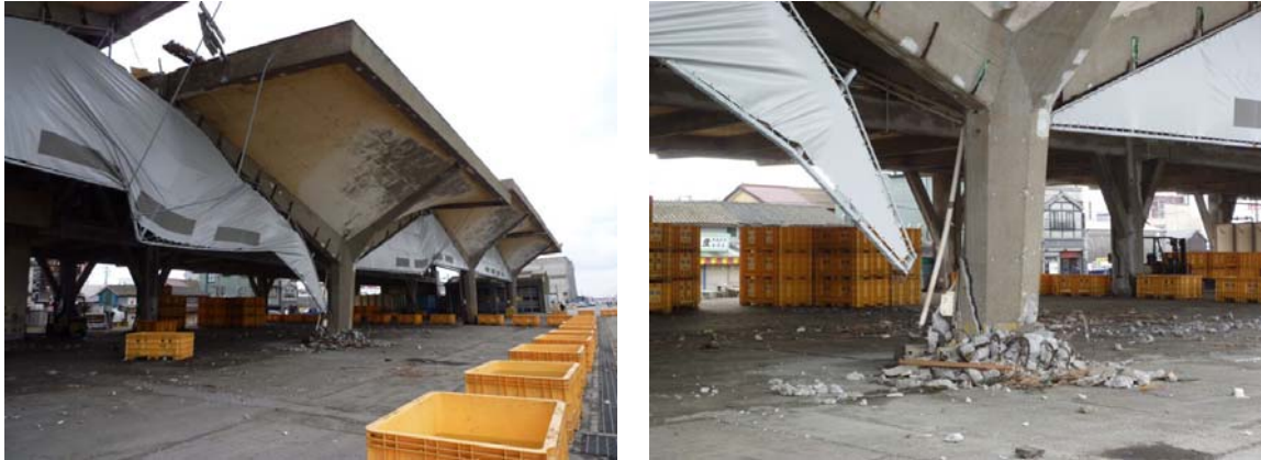
図-2.12.2 第1市場(荷捌所)の被災状況(調査場所①)
