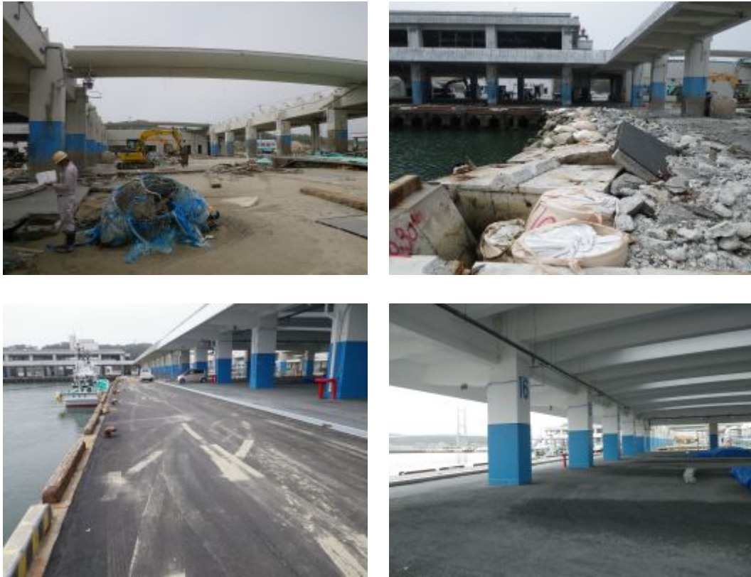
図-2.11.2 魚市場(荷捌所)の被災状況 (調査場所①。下2枚は応急復旧工事が完了)
