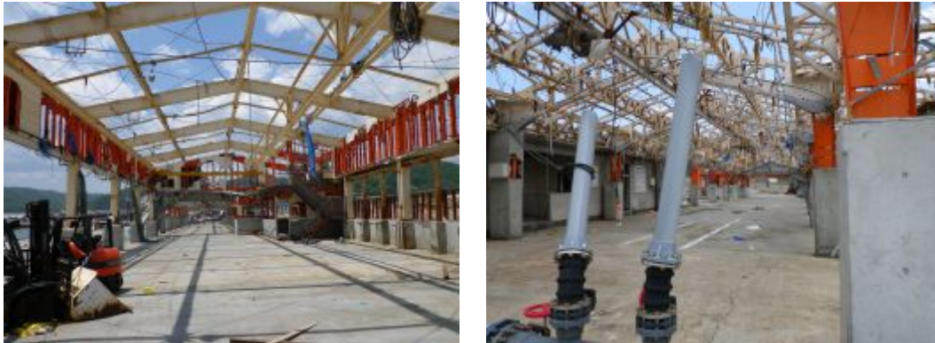
図-2.2.2 荷捌所の被災状況(調査場所①)
