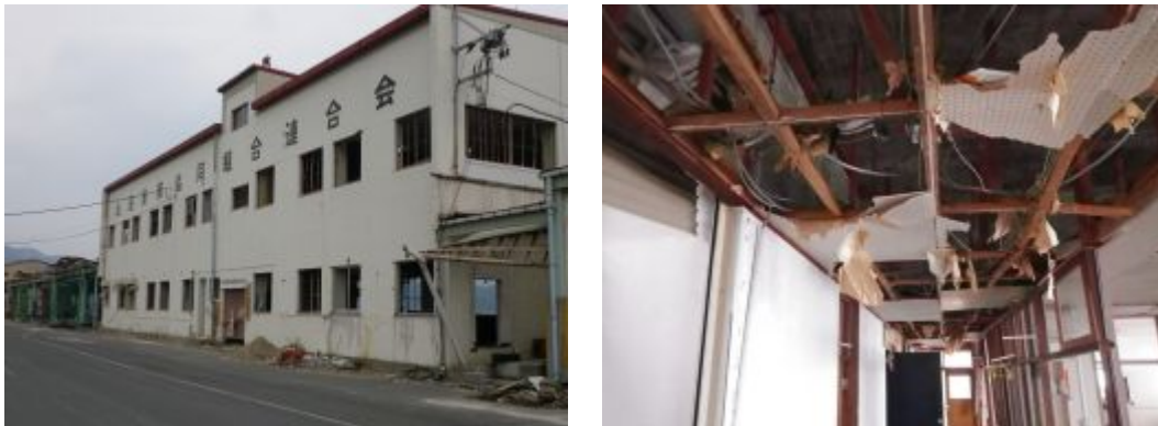
図-2.3.3 漁業協同組合建屋の被災状況（調査場所①）
