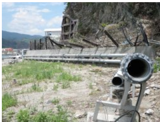
図-2.2.6 切断されている給水施設(調査場所⑤)
