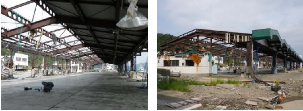
図-2.4.2 魚市場の被災状況（調査場所①）
