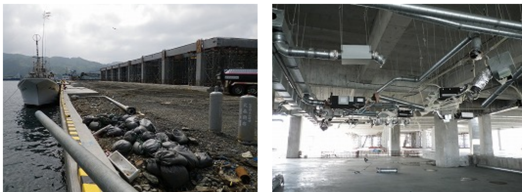
図-2.5.2 整備中の新魚市場の被災状況（調査場所①）
