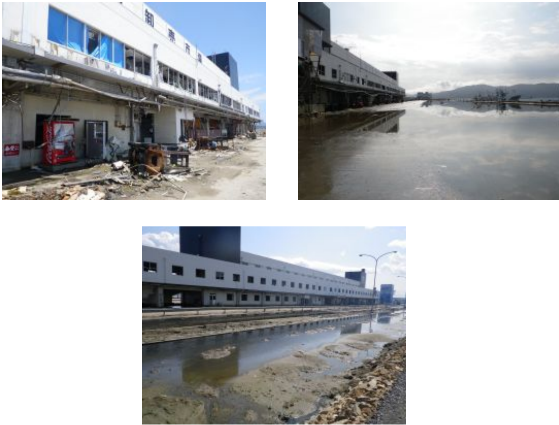
図-2.9.2 石巻魚市場 (調査場所①。左上:荷捌所建屋、右上:冠水状況、下:背後の臨港道路)
