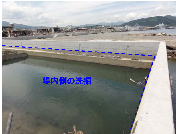
図-5.15 防潮堤の被災状況
