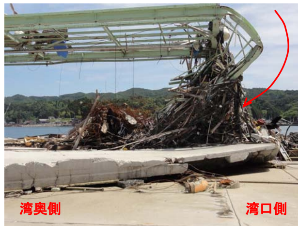
図-5.8 -6.0m 岸壁（魚市場前地区、地盤改良無し）の被災状況（上段右図：上部工撤去区間、上段左図・下段：上部工残存区間）
