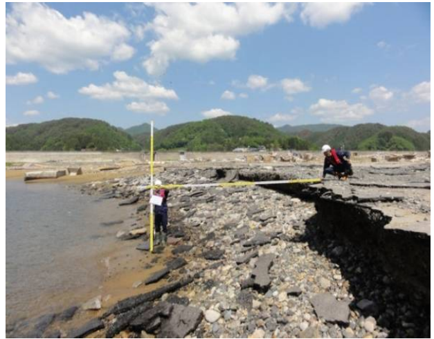
図-1.17 -4.0m岸壁（直立消波ブロック式）の被災状況（漁港南側の北隅角部北側岸壁）
