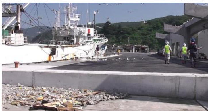
宮城県女川漁港。沈下して水没した岸壁(上)と、応急に嵩上げされた岸壁(下)。(2011年6月)
