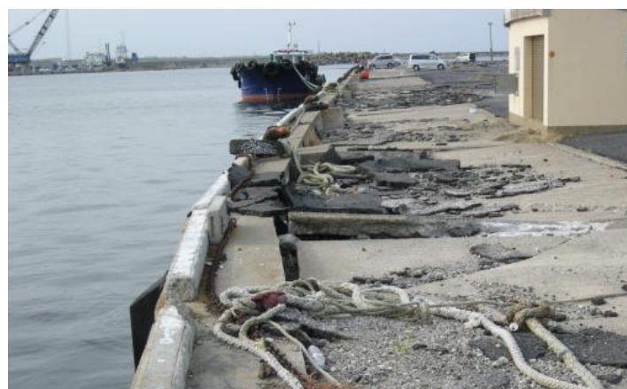
茨城県波崎漁港の矢板式岸壁。海側へはらみ出し、背後のコンクリート板が沈下しました。
