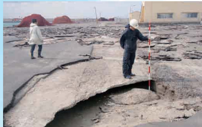
写真1. 3月14日に撮影した漁港・漁港周辺施設の被災状況把握調査の様子 波崎漁港製氷所とその周辺では、路面が陥没したり、舗装がはがれたりしていた
