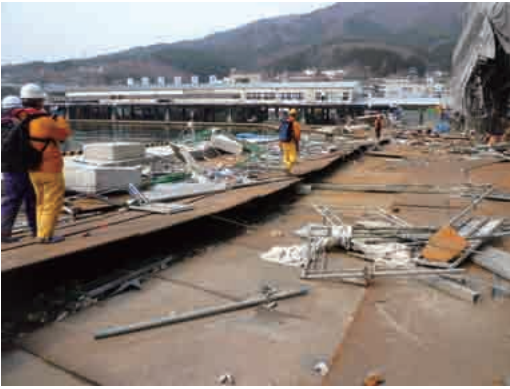
地盤が約70センチ沈下した新市場の岸壁 (大船渡市)
