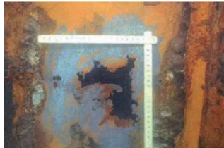
図1 古くなった鉄の柱に開いた孔
