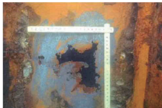
図1 古くなった鉄の柱に開いた孔
