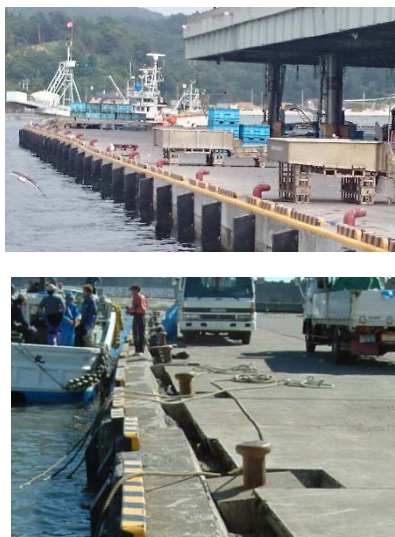
図1 上：通常の岸壁 下：地震により変形した岸壁
