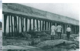
海底地盤中にある木材（護岸木杭）
