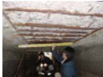
函渠内のコンクリート剥落
