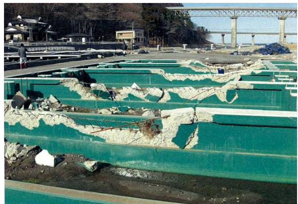
図 2. 津波によって破壊された下安家ふ化場。
