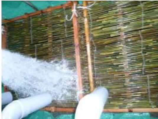
図2. 曝気槽の内部. 内部の基材が撤去されていたため、簡易的に竹を利用した例.
