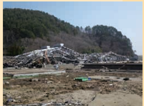
津波により全壊した宮古庁舎 (2011年3月13日撮影)
