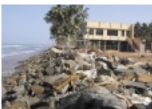
多くが全壊した中で崩壊を免れた新築建物（スリランカ、カルタラ県）
