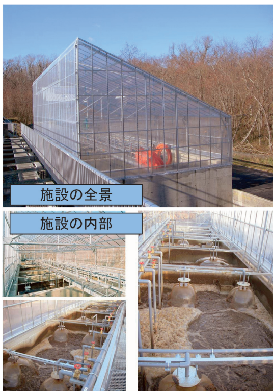
写真 3. 排水処理施設 使用期間が冬場のため、施設内の気温を高め、微生物の活性を促進するためにビニールハウス仕様となっている
