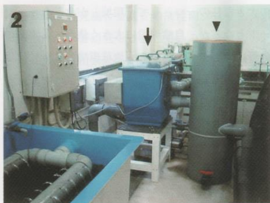
2：沈殿槽とドラムフィルター
