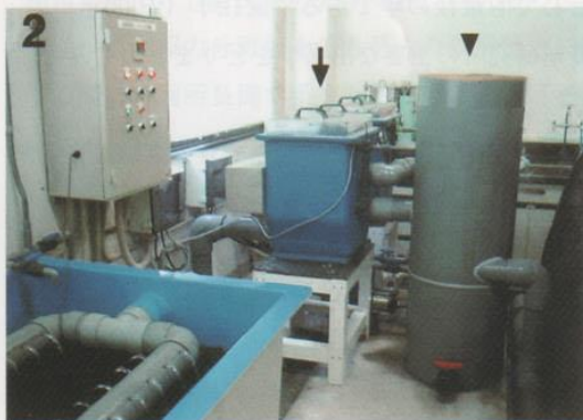
2: 沈殿槽とドラムフィルター
