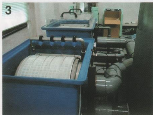
3：ドラムフィルター内部
