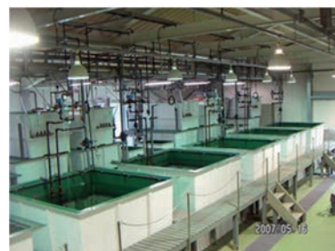
写真3 閉鎖循環システムの試験水槽
