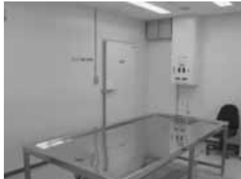
写真1. 冷凍・冷蔵庫室に設置されたステンレス製測定用実験台とプレハブ冷凍・冷蔵庫
