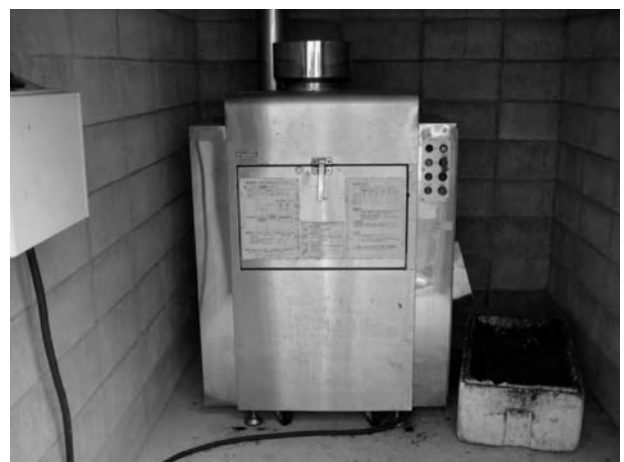
写真Ⅲ-1 廃棄する死亡魚や死卵等を加熱・乾燥処理する生ゴミ処理機
