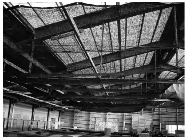
写真II-2-10. 屋根部分に設置した遮光幕 (五島栽培センター)
