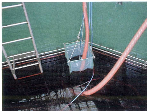
写真IV 2-13 ストレーナを介して排水
