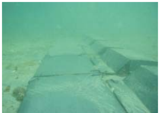
Photo. 6 翼状堆砂促進工設置状況 (逗子ヶ浜 期)
