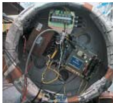
図10 光 - 電気変換部（耐圧容器内）
