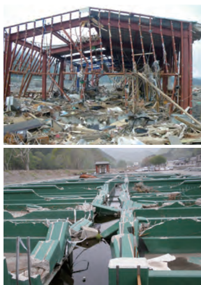
写真1 ふ化施設の被災状況
