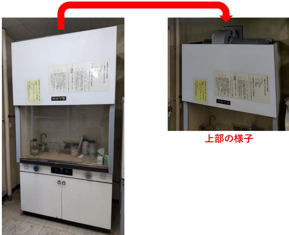
図2 既存の局所排気装置
