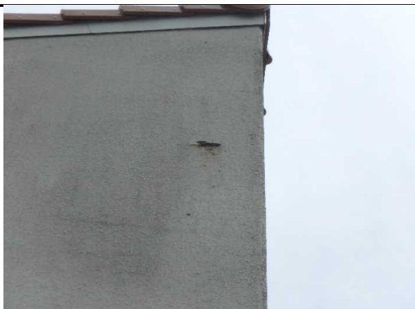
②北側2階丸窓付近の破損箇所
