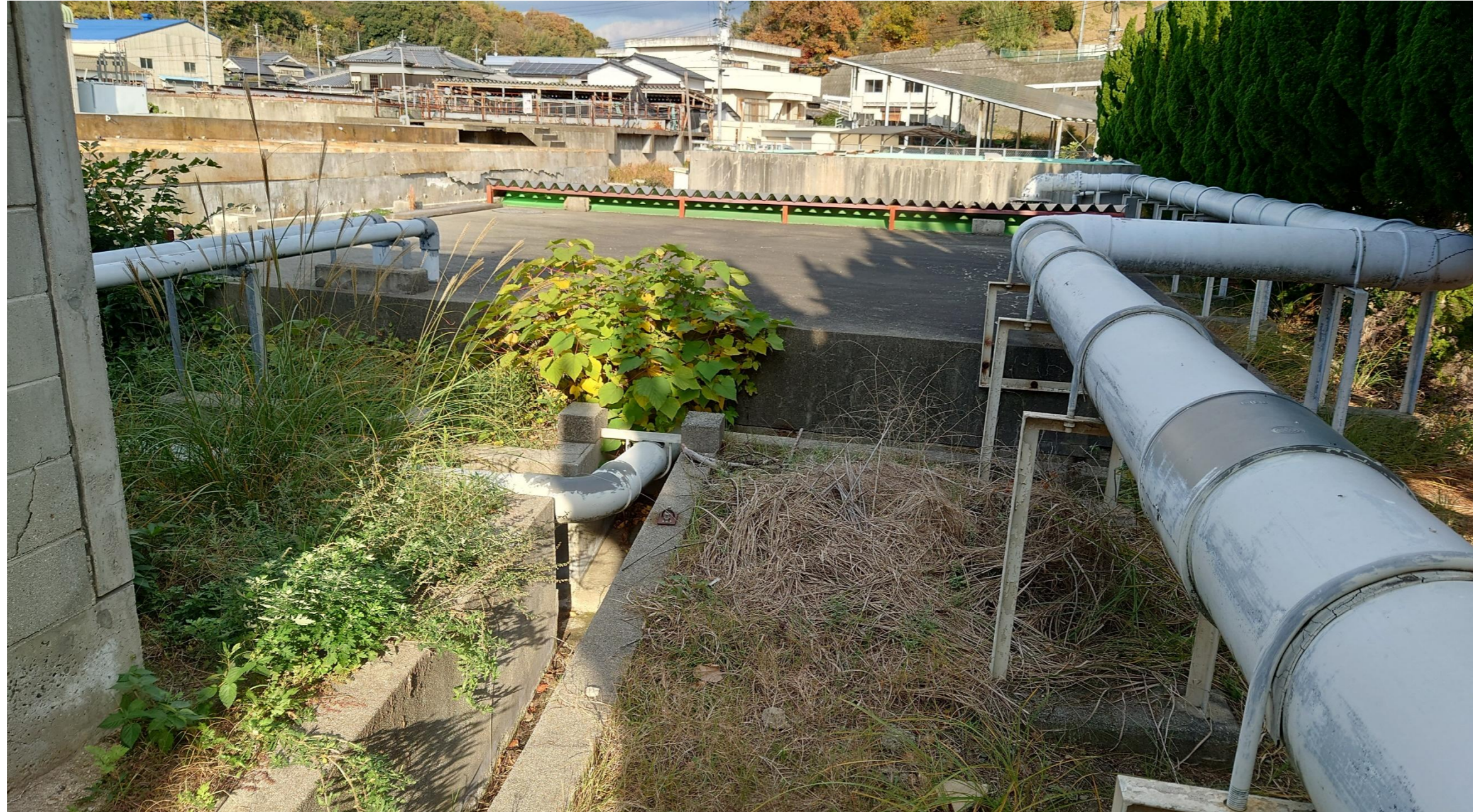
写真：障害物（配管）
