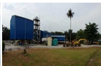
パームトランク燃料化設備
