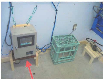
見える化装置を機械室に設置
